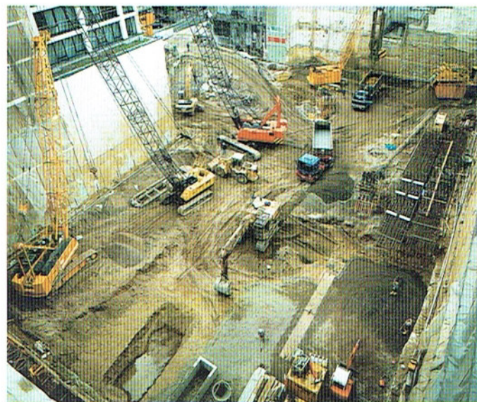
Bild 5: Gesamtaufnahme der Baustelle zum Zeitpunkt der Erstellung der Schlitzwände und der vorbereitenden Arbeiten der Primärstützen
